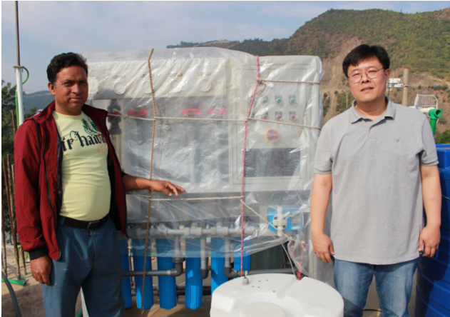
[팀앤티팀 설치 정수시설]
